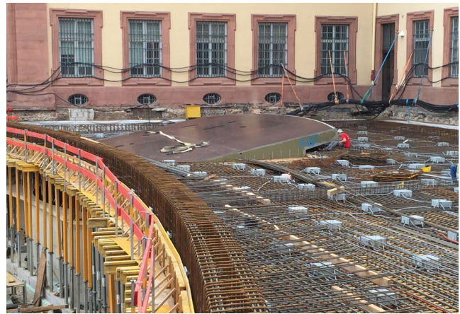
Als Unterbau diente ein Traggerüst mit Schalträgern und Schalboden im waagerechten Bereich.
